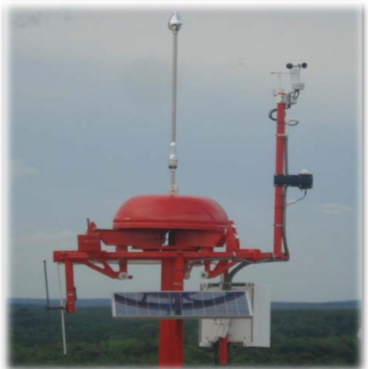
ภาพที่ 5 เสาวัดลมในระบบ LLWAS
